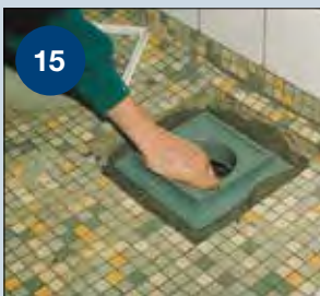
15 Toppen monteres i flangens O-ring og trykkes i betonen med en let vibrering.
