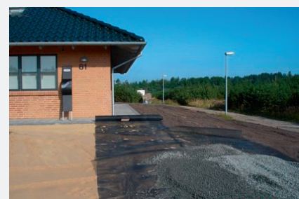
Skærverne (ca. 20 cm) udlægges oven på armeringsnettet, der sikrer et stabilt underlag
