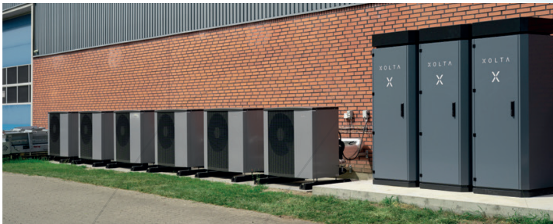
Strøm fra XOLTA batterierne er med til at drive varmepumperne.
