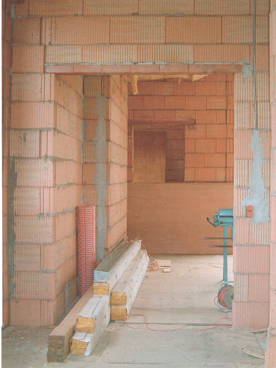
Indvendige skillevægge udføres i smallere blokke, hhv. 110 mm for ikke bærende vægge under 3 m, og 175 mm for højere og bærende skillevægge. El- og andre installationer fræses ind i blokkenes overflade, eller føres synligt. Foto Anne Beim
